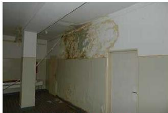
Zatékání vadnou krytinou
